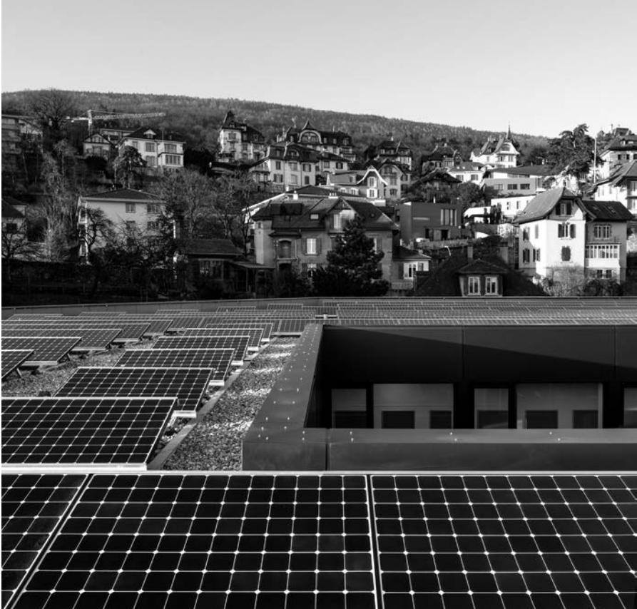
Figure 5 : Centrale photovoltaïque installée sur la toiture du bâtiment et reliée au réseau électrique de la ville. (photo : Yves André)
