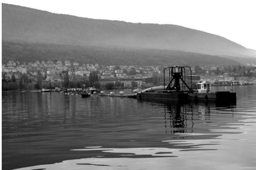
Figure 6 : Mise en place de la conduite sous-lacustre et de la crépine du réseau d'eau du lac utilisé pour le rafraîchissement écologique des bâtiments du quartier, dont Microcity. (photo : Viteos SA)
