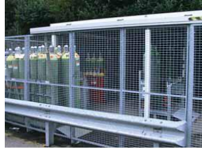
Glissière de protection
