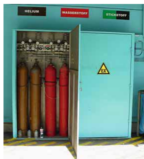
Alimentation centrale en gaz
