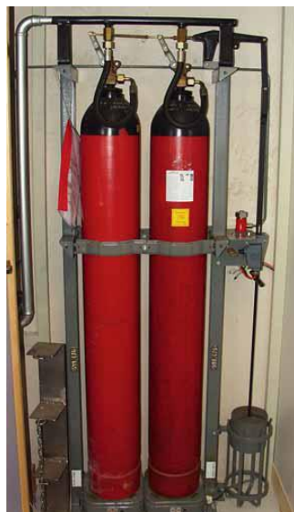
Poste fixe d'extinction au CO2
